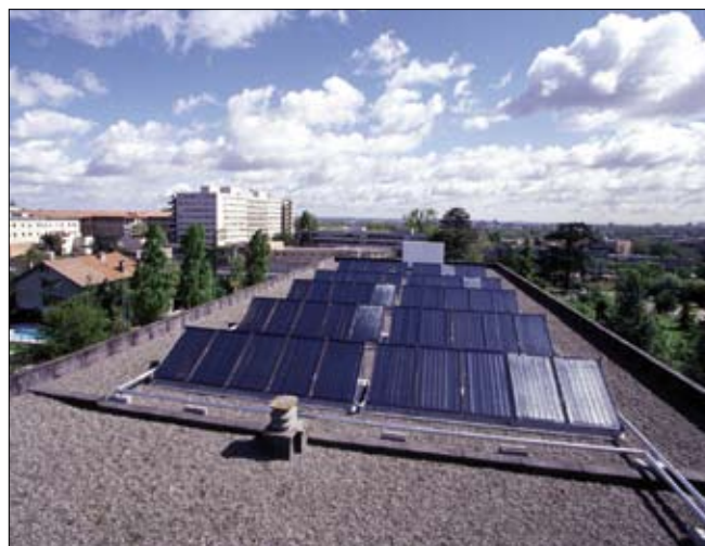
Installation solaire thermique en toiture (Lyon Confluence) © Hespul.
